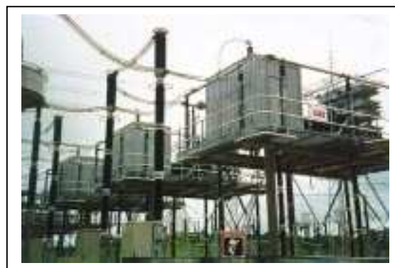
Fig.12 : View of the Imperatriz 500 kV TCSC.
