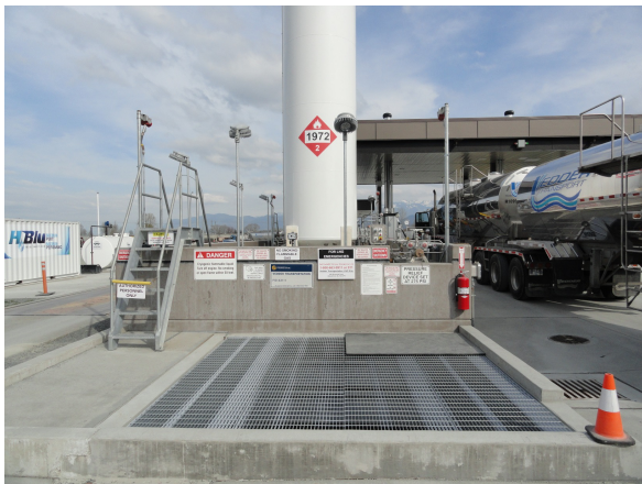
LNG Fueling Station
